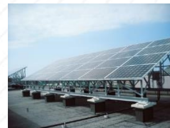
太陽光発電設備
