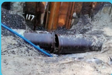
送水管の被害状況(令和6年能登半島地震)
