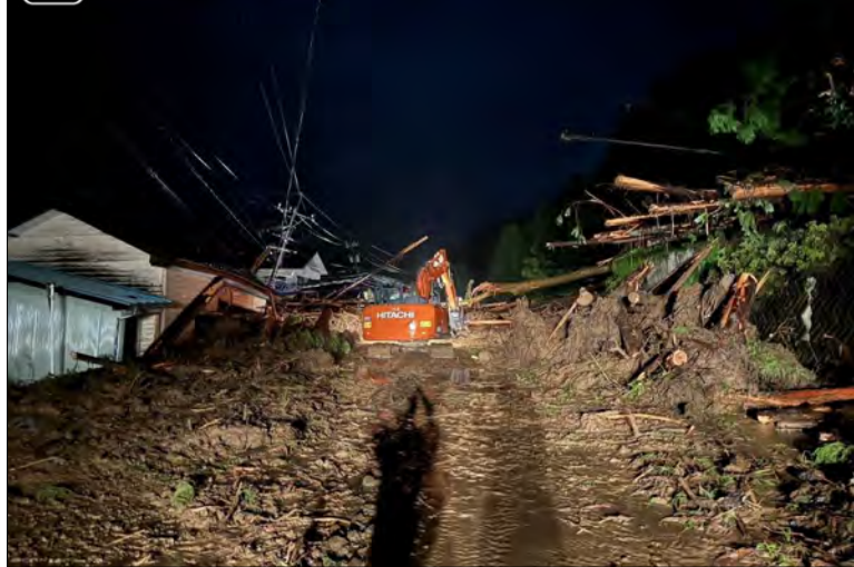
道路啓開状況
