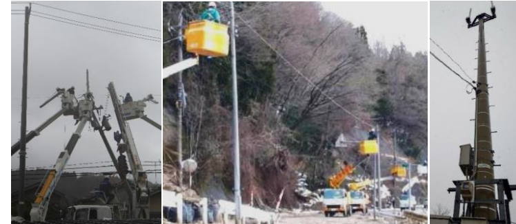
商用電源の復旧 (北陸電力送配電) 光ファイバの張替 (NTT西日本) 基地局の修理 (NTTドコモ)
