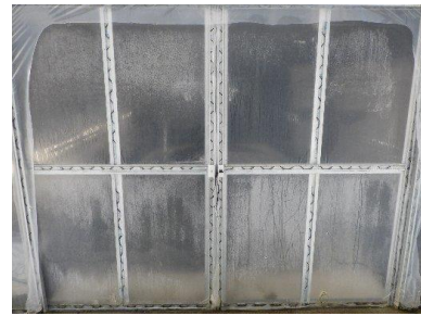
内側に結露したハウス
