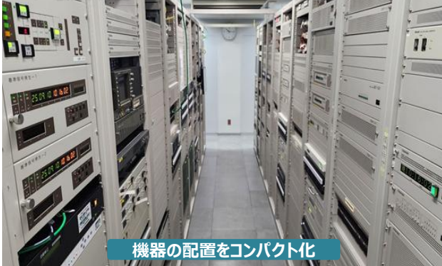
マスター設備ラック室
