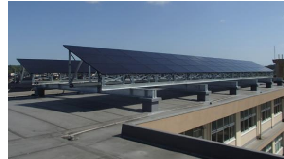
志賀高校に設置した太陽光発電設備
