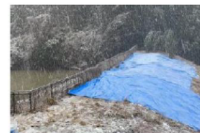
ため池堤防の崩壊 (輪島市)
