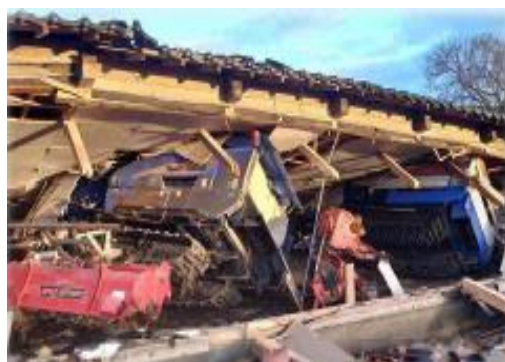
農業機械・納屋損壊(輪島市)
