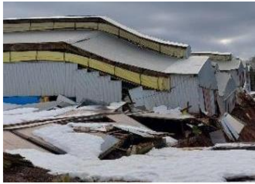
畜舎の倒壊(能登町)
