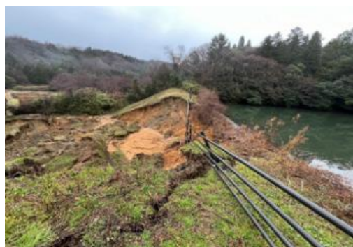
ため池の堤防崩壊(宝達志水町)
