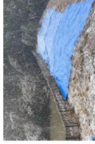
ため池堤防の崩壊 (輪島市)
