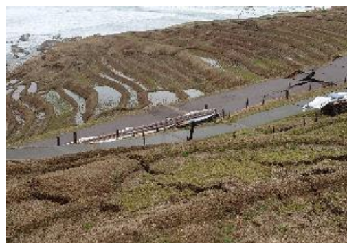
白米千枚田の亀裂・法面崩壊(輪島市)
