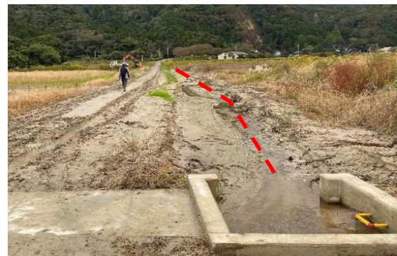
水路埋塞(輪島市)
