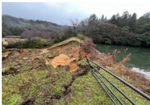
ため池の堤防崩壊(宝達志水町)
