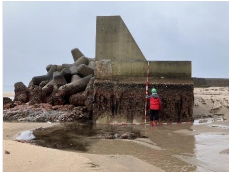
地盤隆起（鹿磯漁港（輪島市））
