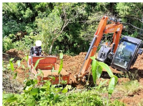
復旧状況①
