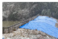
ため池堤防の崩壊 (輪島市)
