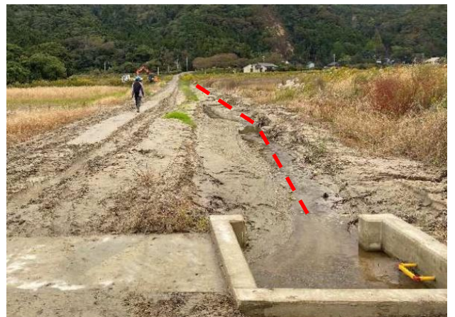
【豪雨】水路埋塞（輪島市）
