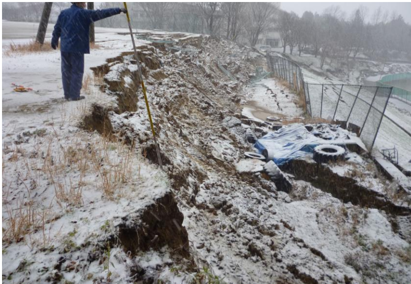
地すべり崩壊（輪島市稲舟町地内）
