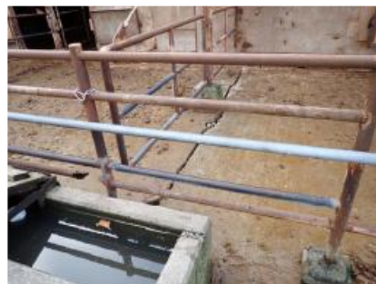
能登畜産センター：牛舎のひび割れ
