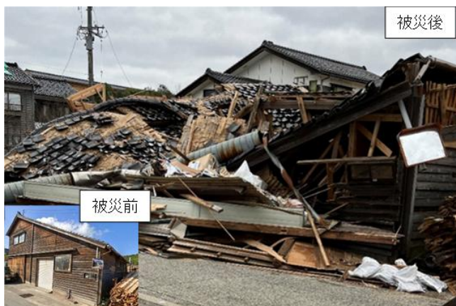
【地震】製材工場の損壊（輪島市）
