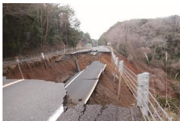
のと里山海道の被害
