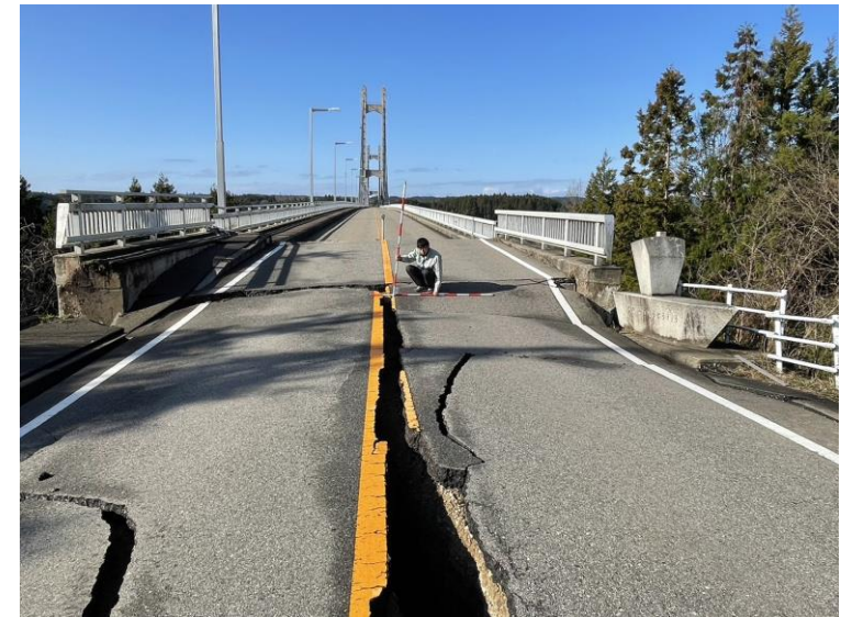
農道橋損壊（七尾市能登島半浦町）
