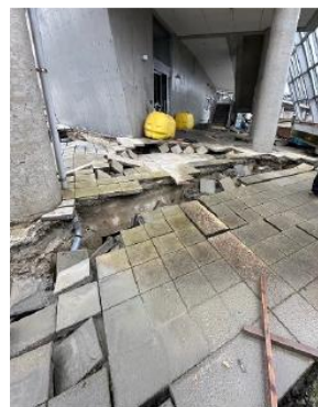
水産総合センター（本所）：地盤沈下
