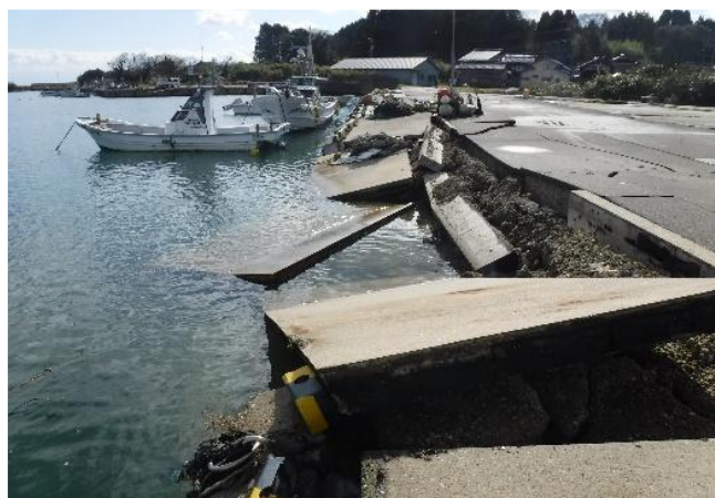
【地震】岸壁の損壊（七尾市）
