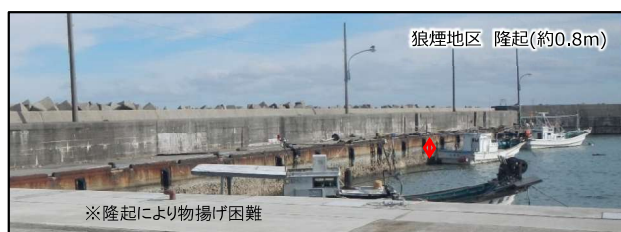
狼煙漁港（珠洲市）
