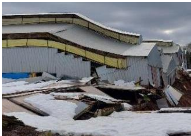
【地震】畜舎倒壊（能登町）
