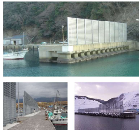
係留施設に設置した防風柵
