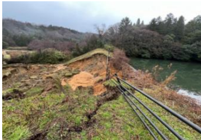
【地震】ため池堤防崩壊（宝達志水町）
