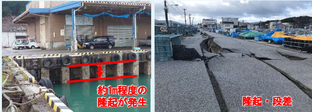
輪島港（輪島市）
