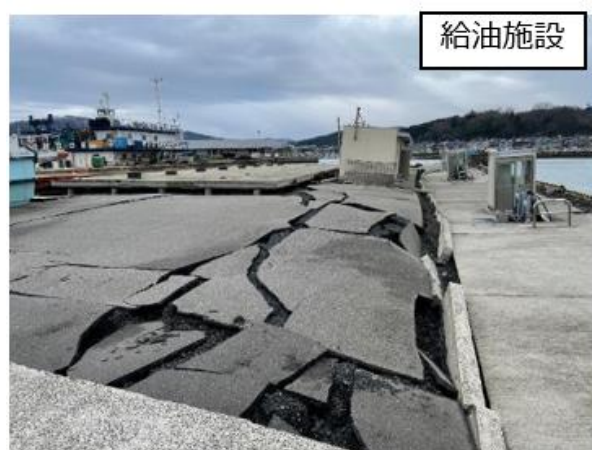
【地震】給油施設の損壊（輪島市）
