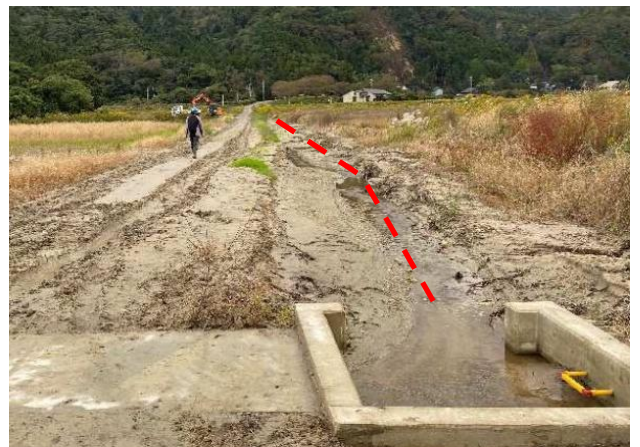
【豪雨】水路埋塞（輪島市）
