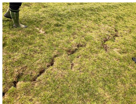
自主復旧が可能な亀裂程度の例 (幅 10cm×深さ 10cm 程度)
