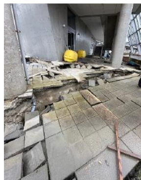
水産総合センター（本所）：地盤沈下
