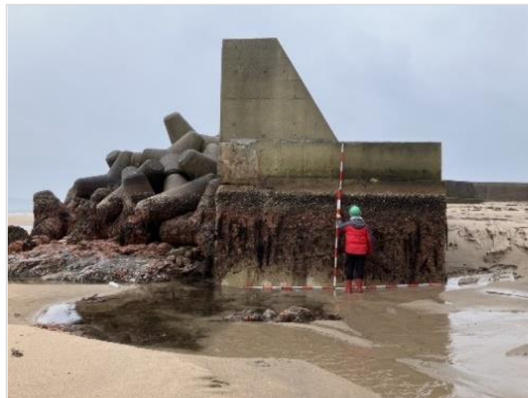
地盤隆起（鹿磯漁港（輪島市））
