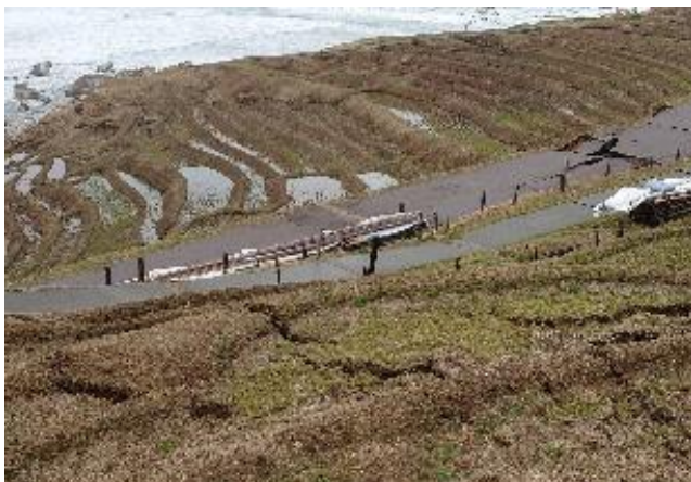
【地震】白米千枚田の亀裂・法面崩壊（輪島市）
