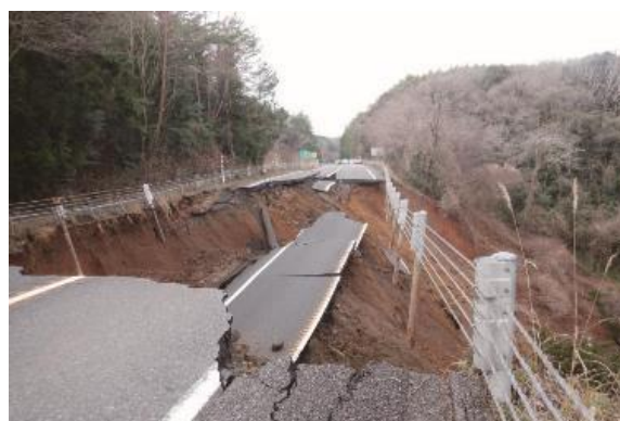
のと里山海道の被害
