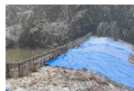
ため池堤防の崩壊 (輪島市)
