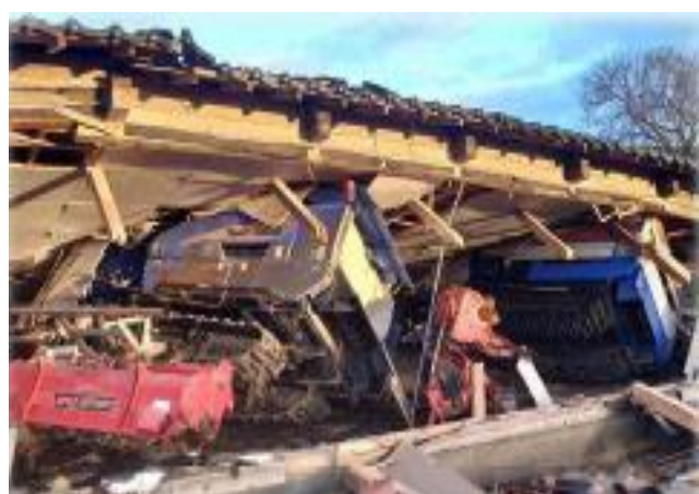
【地震】農業機械・納屋損壊（輪島市）
