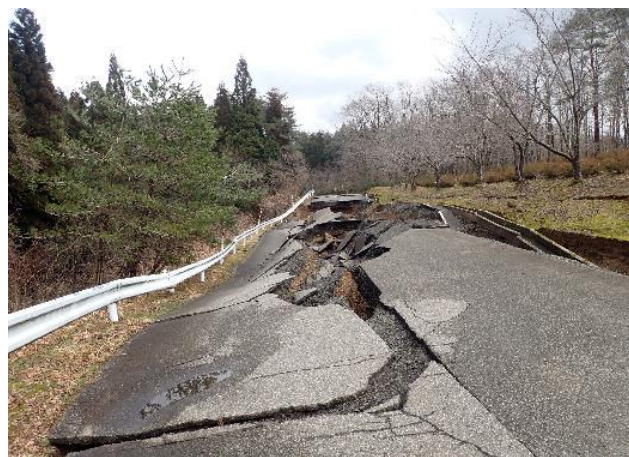
【地震】林道崩壊（輪島市）
