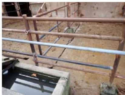
能登畜産センター：牛舎のひび割れ
