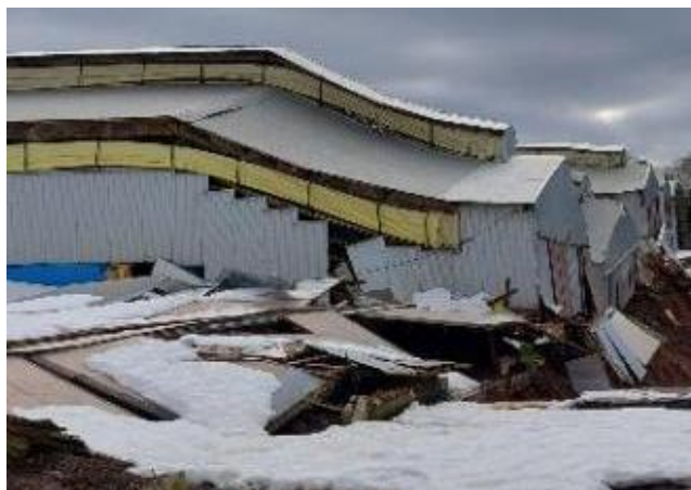
【地震】畜舎倒壊（能登町）
