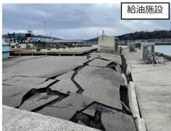
【地震】給油施設の損壊（輪島市）
