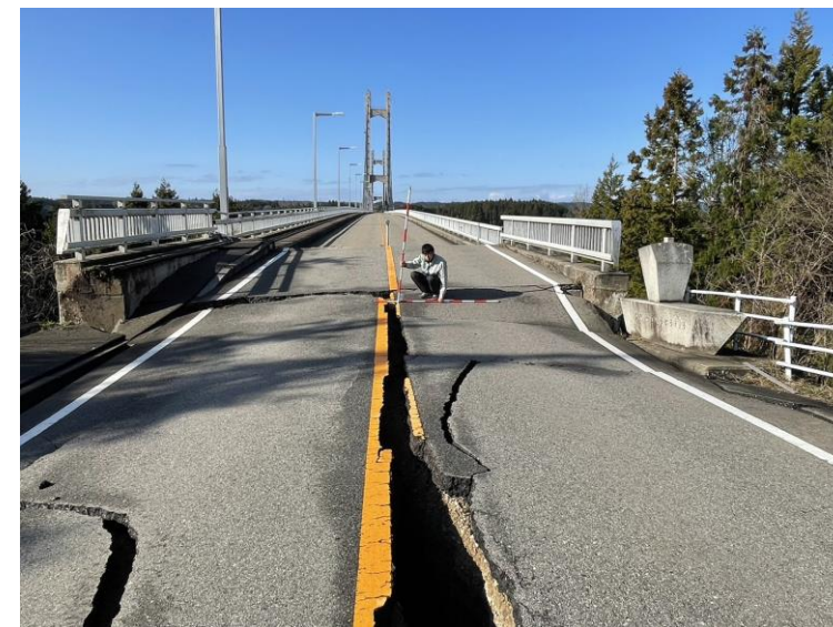
農道橋損壊（七尾市能登島半浦町）
