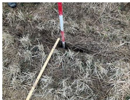
自主復旧が可能な亀裂程度の例
