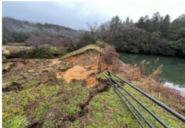
【地震】ため池堤防崩壊（宝達志水町）
