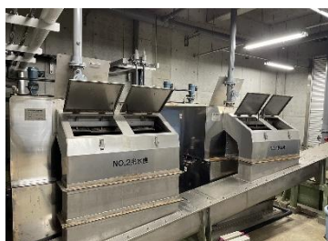
汚泥脱水機の内部部品の破損により、異音が発生 （修繕までの間は、75%出力で運用）
