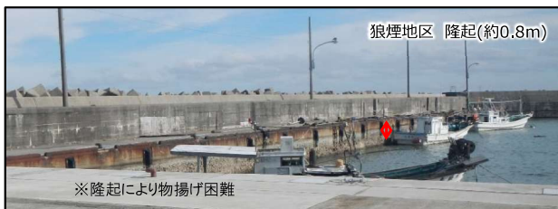
狼煙漁港（珠洲市）
