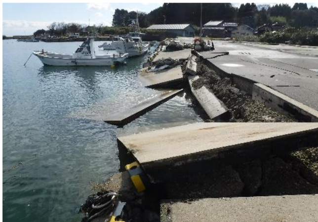
【地震】岸壁の損壊（七尾市）
