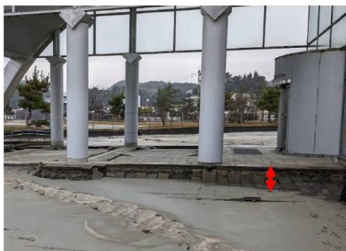
水産総合センター（本所）：地盤沈下
