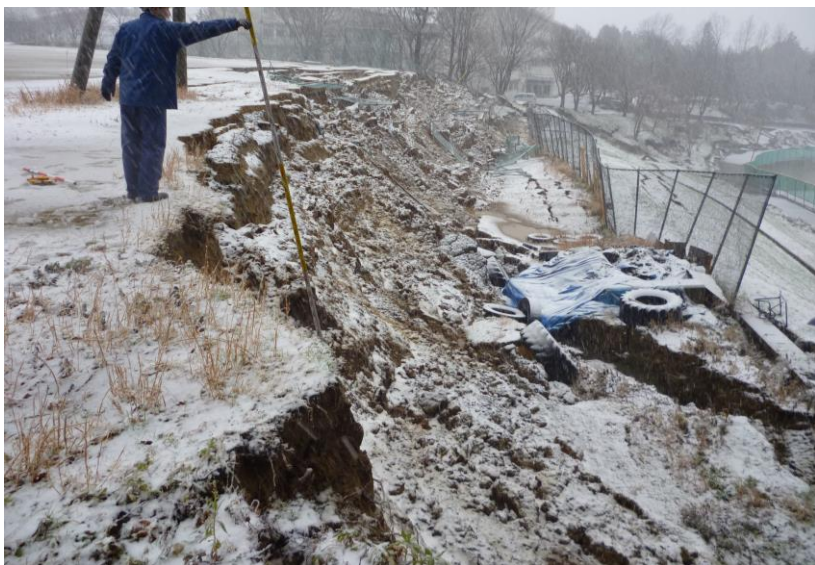
地すべり崩壊（輪島市稲舟町地内）
