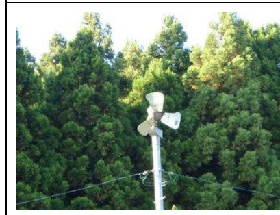
カキ園に設置された防霜ファン
