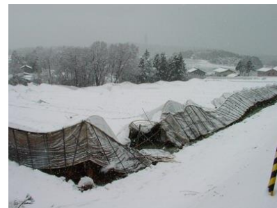
連棟ハウスは特に雪に弱い
