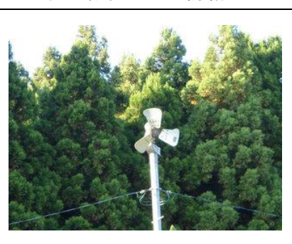
カキ園に設置された防霜ファン
