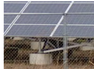
<太陽光発電施設>
