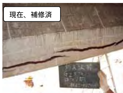
塩害劣化橋梁
