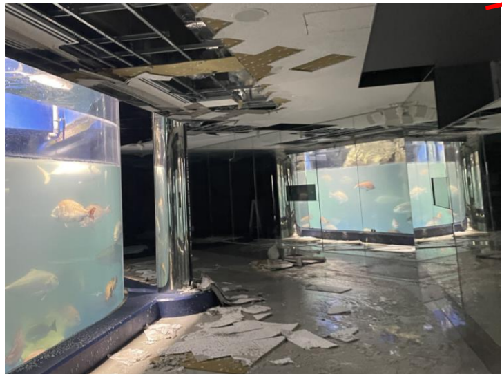
のと海遊回廊天井落下
