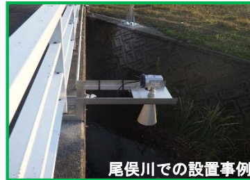
水位計・河川監視カメラの活用・増設（石川県）
