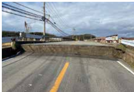
橋梁の段差(国道249号 志賀町清水今江)
