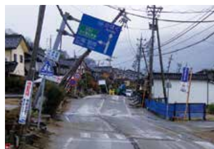
4 液状化((主)松任宇ノ気線 内灘町西荒屋)
