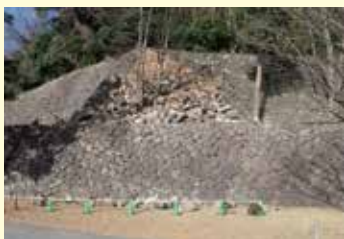
石垣の崩落（本丸南石垣）
