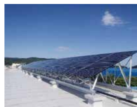
太陽光発電パネル （各県立学校）
