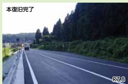
国道249号(穴水町志ヶ浦)
