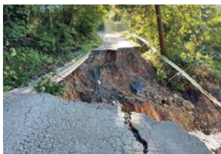
道路の崩落((一)高屋出田線 珠洲市若山町)
