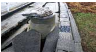
能登半島地震の被災状況（珠州市）
