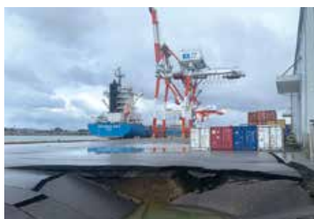
舗装の沈下(金沢港 御供田ふ頭)
