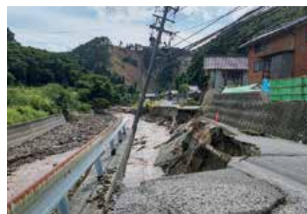
兼用護岸の被災(珠洲大谷川 珠洲市大谷町)
