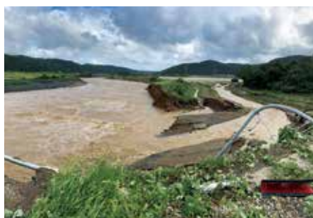
堤防の決壊(町野川 輪島市町野町大川)
