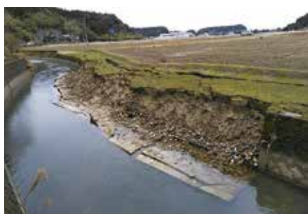
護岸損壊(崎山川 七尾市鷺浦町)
