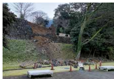
石垣の崩落(金沢城公園)
