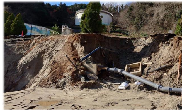
浄水場の被災
