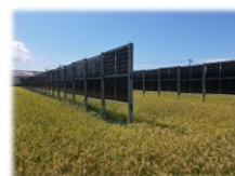
▲垂直型太陽光発電設備
