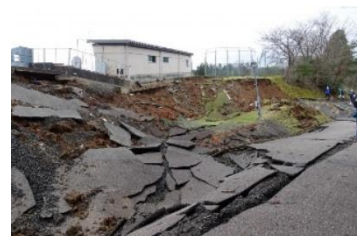
地震による被害
