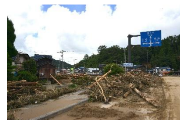
豪雨による被害
