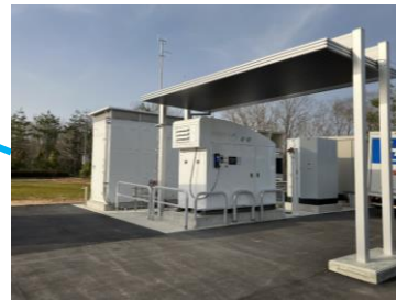
能登水素ST (のと里山空港内)
