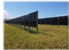
▲垂直型太陽光発電設備
