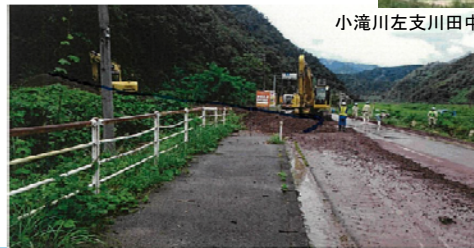
土砂流出により国道148号が一時全面通行止め (糸魚川市大字根小屋)
