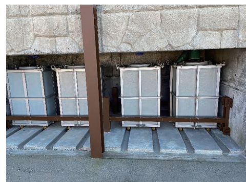
写真2 室堂の冬季トイレカートリッジ
