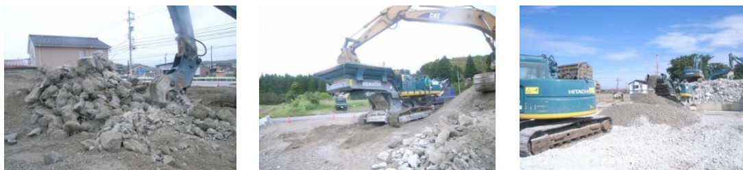
コンクリート塊は現場で破砕、粒度調整して建築資材化
