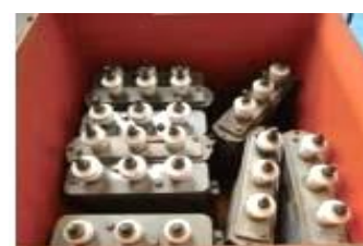
鋼製容器への収納例
