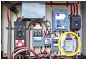
低圧分電盤内の低圧コンデンサー
