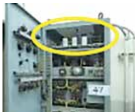
可変周波数電源装置に取り付けられた 低圧コンデンサー
