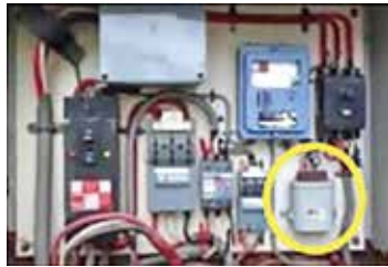
低圧分電盤内の 低圧コンデンサー
