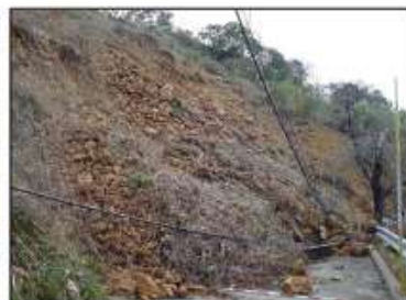
道路法面崩壊
