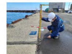
上部工背後の段差
