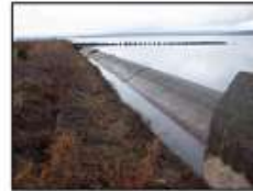
【能登島海岸】 堤防の倒伏
