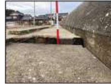
【石崎海岸】 天端の沈下
