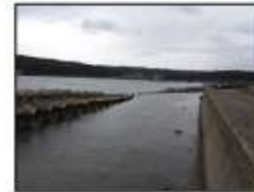
【穴水海岸】 消波工の沈下
