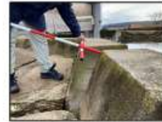
【和倉海岸】 堤防の傾斜
