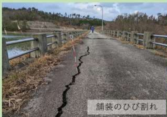
地震後のダム堤体の被災状況
