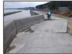
【田鶴浜海岸】 天端の沈下
