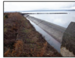
【能登島海岸】 堤防の倒伏
