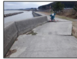
【田鶴浜海岸】 天端の沈下
