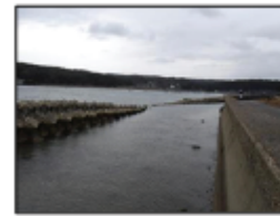
【穴水海岸】 消波工の沈下
