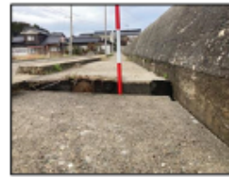
【石崎海岸】 天端の沈下
