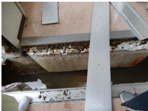
建物連結部の損傷
