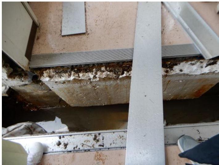
＜建物連結部の損傷＞
