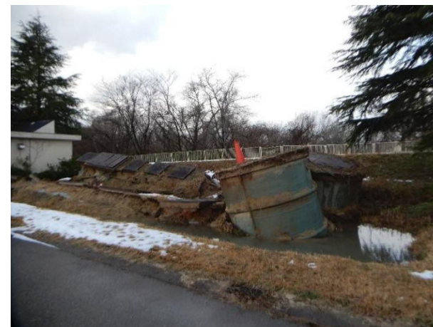
液状化による被害
