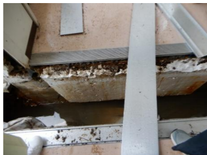
建物連結部の損傷
