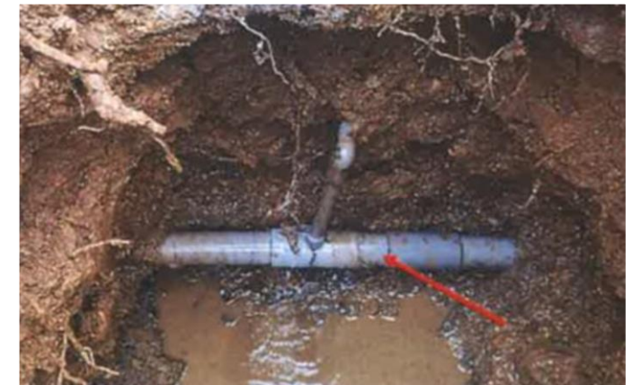
破断した水道管
