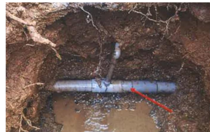
破断した水道管
