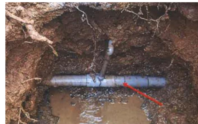
破断した水道管
