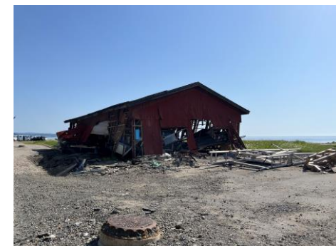
津波により損壊した保管庫
