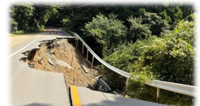
崩落箇所② 羽咋市神子原町
