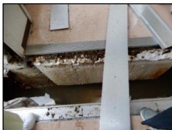
建物連結部の損傷
