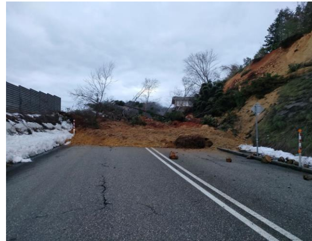
被災道路の状況
