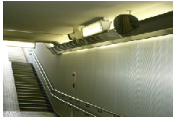
防犯カメラ、通報装置、死角をなくすミラーが設置された地下道
