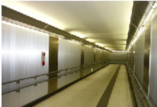
通報装置が設置された地下道
