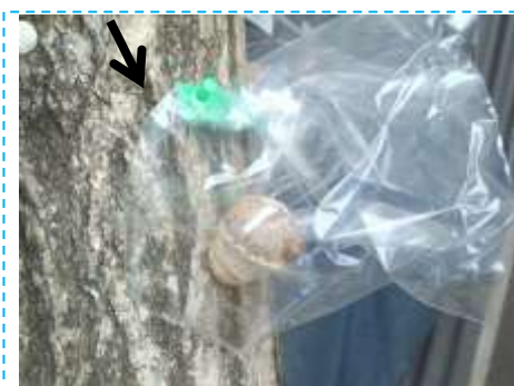
荷造りバンドで補強した例 (矢印)
