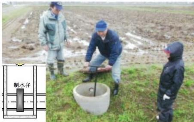
弁の動作確認状況
