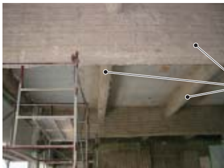
【石綿含有吹付け材 [吹付け石綿]】
