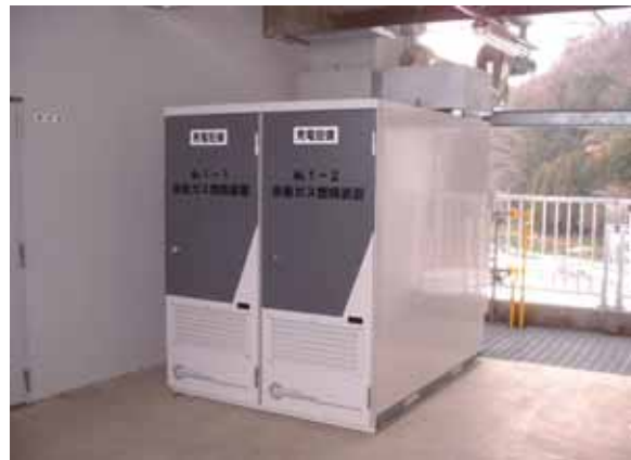
マイクロガスタービン発電設備
