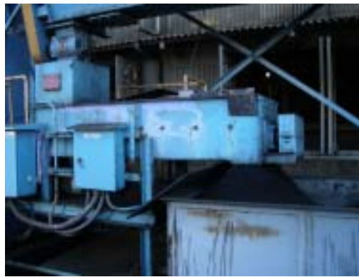
図3-16 集じん廃砂の加湿機（シャワー式の例）
